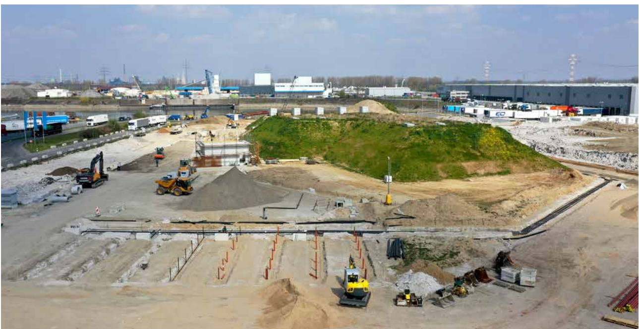
Die Bauarbeiten auf dem Krefelder Hafeneck der Westfalen Gruppe schreiten voran – die erdgedeckten Behälter sind bereits begrünt.
