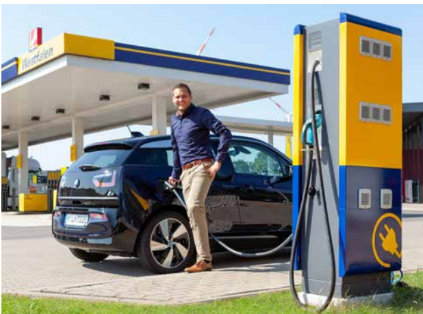
Die Westfalen Gruppe stockt die Zahl der Stromladesäulen an ihren Tankstellen auf.
